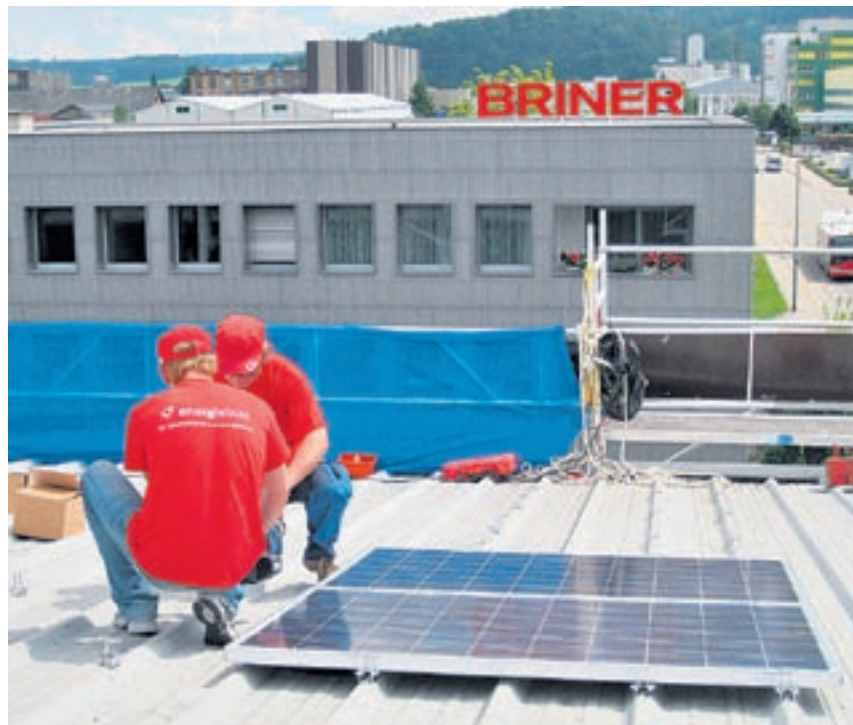
Dieser Tage begann die Montage des Solarkraftwerks auf dem Hallendach. Bild: pd
